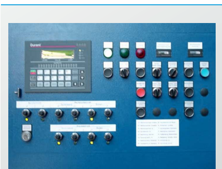
Electric cabinet. Schaltschrank.
